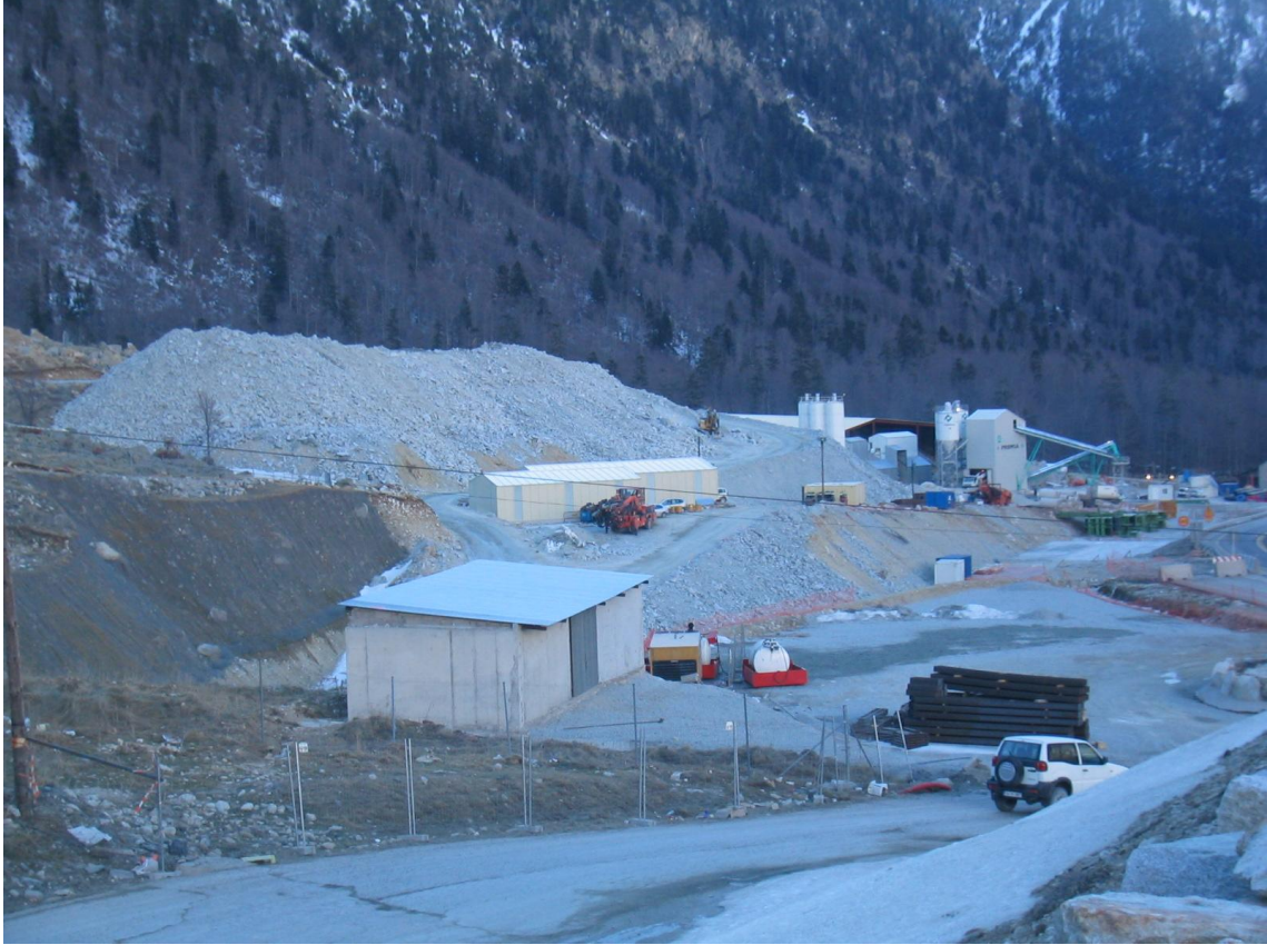
ZONA INSTALACIONES AUXILIARES TÚNEL
